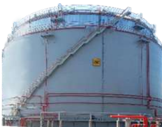
Цилиндрический резервуар с защитной стенкой («стакан в стакане») (РВСЗС)
